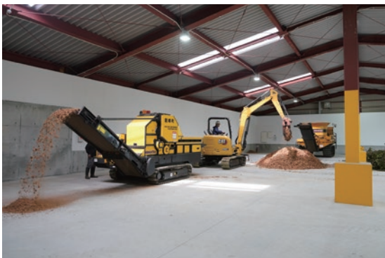
敷料施設内の木材破碎状況
