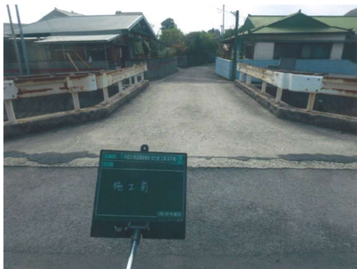
【前平橋：修繕前】
