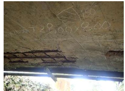
【健全性Ⅲ：山田橋】
