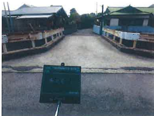
【前平橋 : 修繕前】
