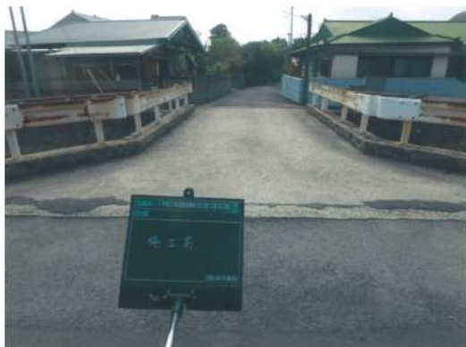
【前平橋：修繕前】
